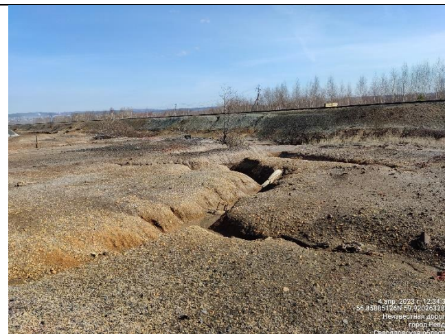
Промоины в южной части участка рекультивации
