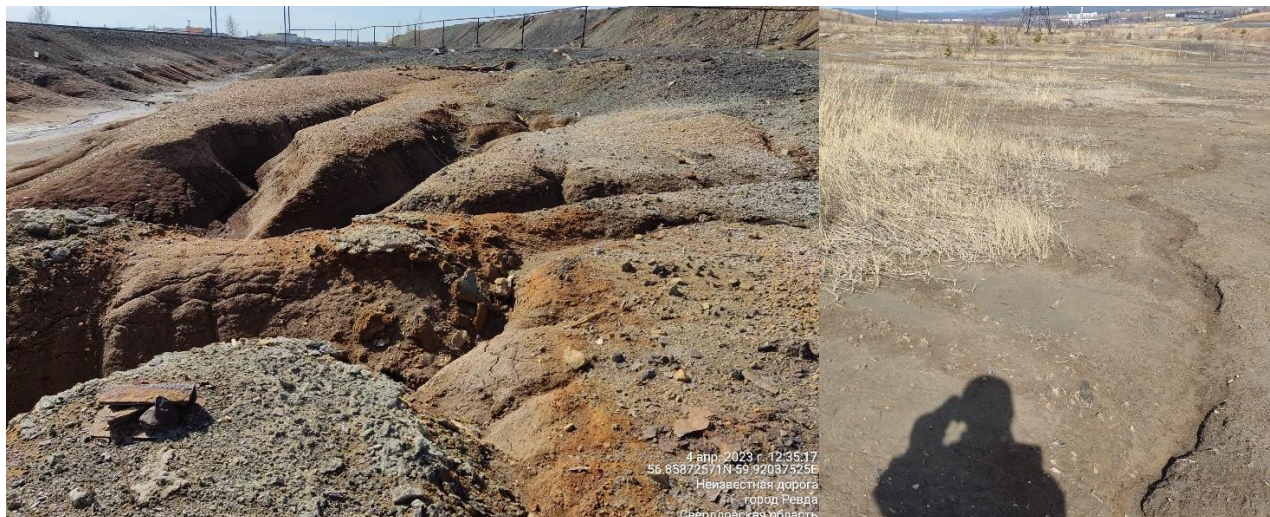
Рисунок 3.2.1 Рытвины и промоины в южной части участка работ возле ж/д полотна
