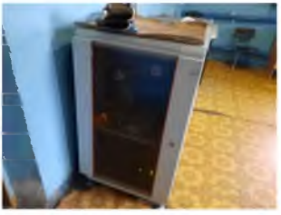
Рис.2 Шкаф телекоммуникационный в помещении дежурного по депо
